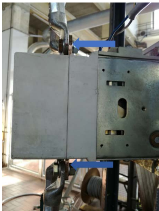
Fig. 35°. Terminali di connessione del contattore su cui sono state eseguite le misure di temperatura.
